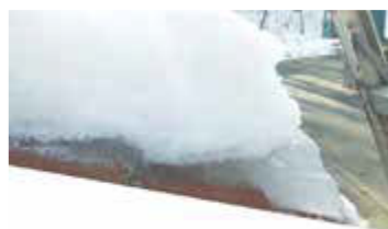
スガモレ：寒冷地では屋根裏に熱がこもると屋根の雪が解け軒先で冷やされ写真のように氷のダムができて雨漏れの原因になる。
